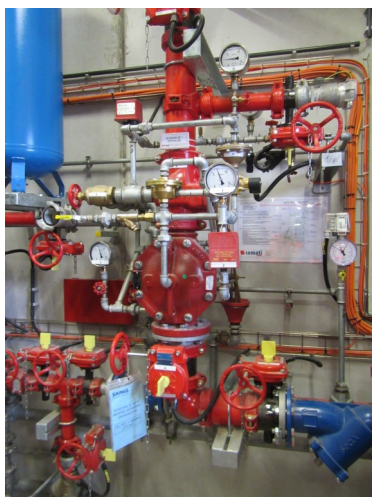
Onderdeel van de brandbeveiligingsinstallatie
