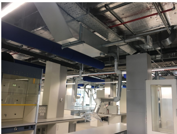
Luchtbehandelingssysteem in een laboratorium
